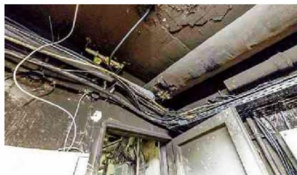
Der Keller, wo der Kabelbrand entstand. Brandschutztüren haben geholfen, Schlimmeres zu verhindern. FOTO: KLITZSCH
